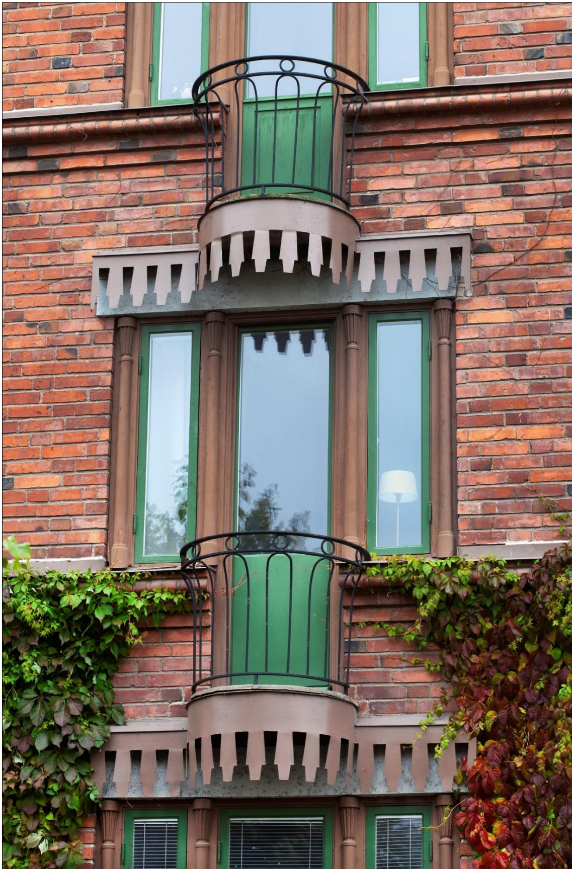
Halvrunda balkonger på fasaden mot Geijersgatan med smidesräcke, flankerande kolonnetter i trä med kapitäl i anslutning till fönster och balkongdörr, baldakiner i klippt plåt under balkonger och ovanför fönster
