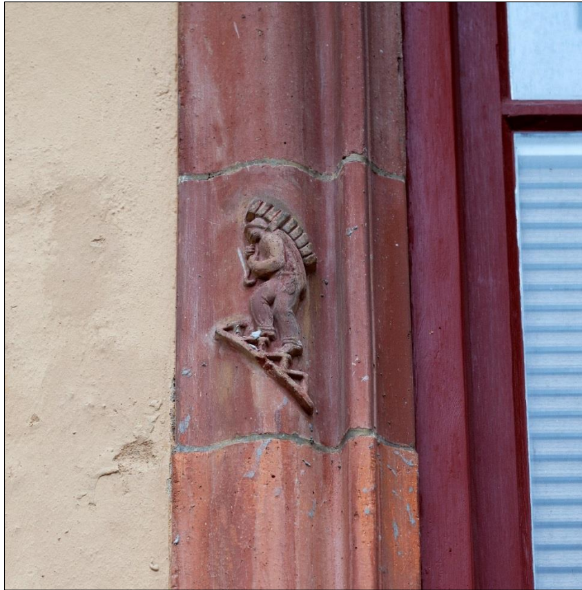
Skulpterat omfattningstegel med tegelbärare som motiv på fönsteromfattning till böger om entrédörren
