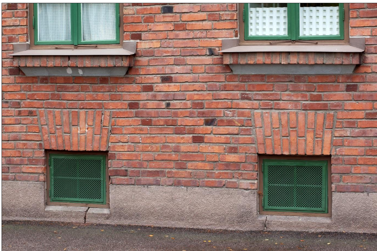
Byggnadens gjutna sockel mot Viktoriagatan, skyddsgaller för källarfönstren, mönstermurning ovanför källarfönstren och bröstning under lägenhetsfönstren
