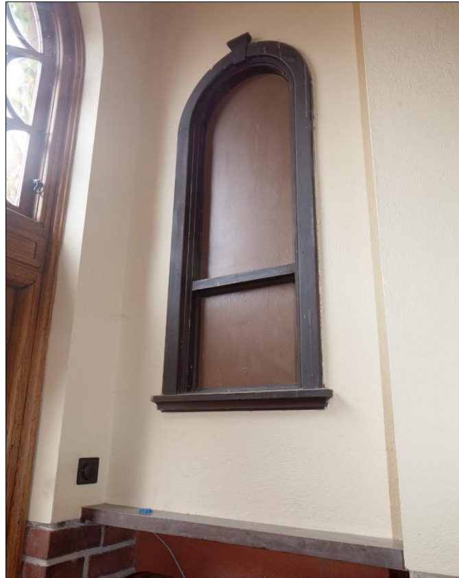
Portvaktslucka till vänster innanför porten i entréhallen, med brunmålad rundbågig karm. Planritningen redovisar en dubblett innanför portvaktsluckan
